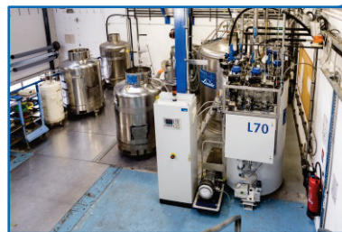
Hall de récupération et de compression du gaz hélium associé à un liquéfacteur d'hélium
